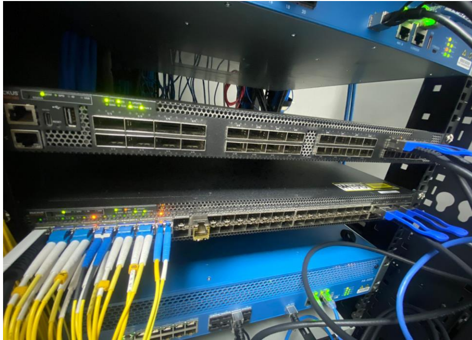
Core de fibra óptica de alta velocidad Enlaces superiores de más de 100 gigas
